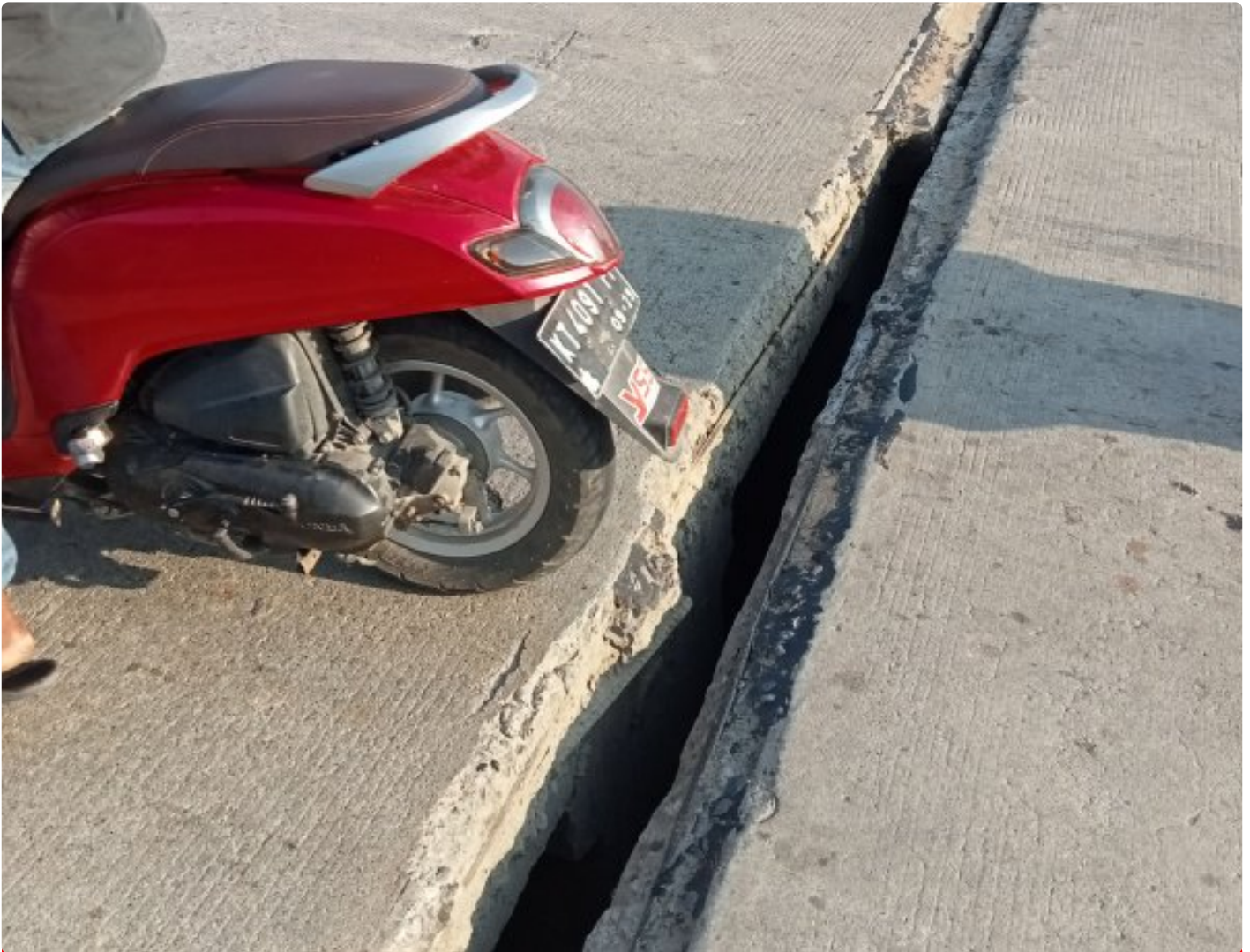
Nampak lubang selebar 20 cm di sambungan jalan fly over Pekkae
