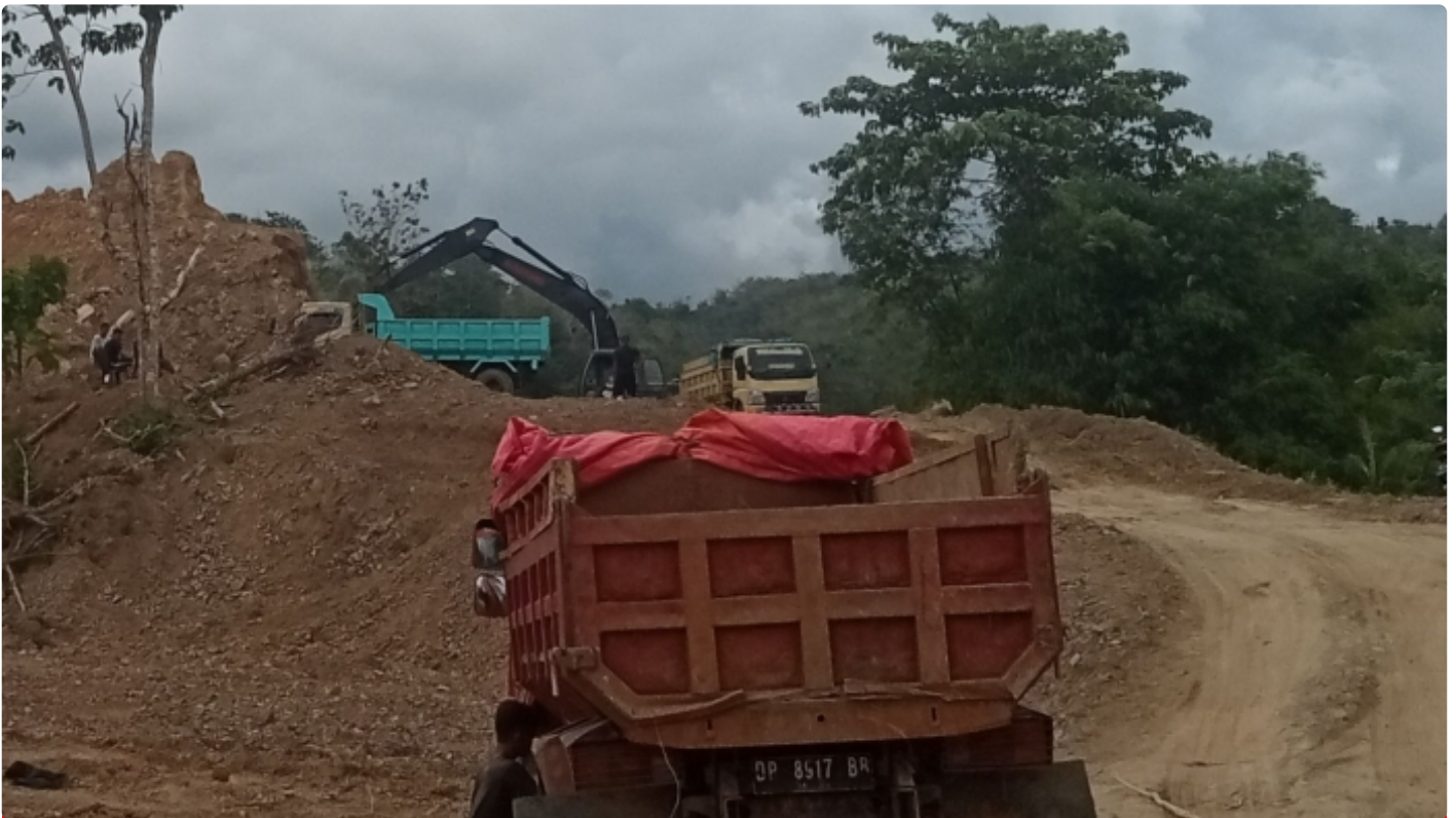
Aktifitas tambang diduga ilegal di Kajuara, desa Lempang, kecamatan Tanete Riaja, kabupaten Barru
